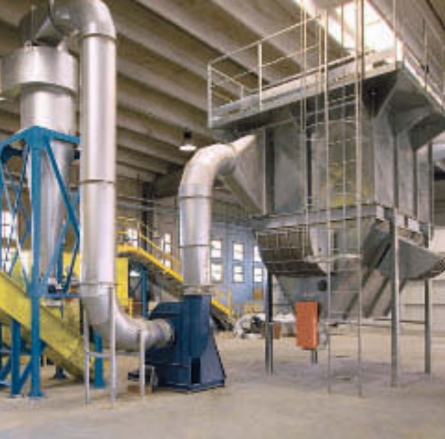
Impianto di cogenerazione a pirolisi per la produzione di energia elettrica e termica da biomassa.
